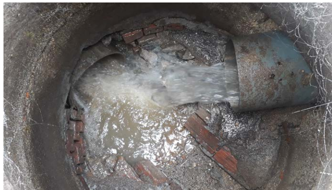
Imagem 1: Fundo de caixa de infraestrutura pluvial severamente erodido.
