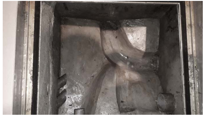
Imagem 3: Caixa de infraestrutura de saneamento com elevada quantidade de admissão de coletores.
