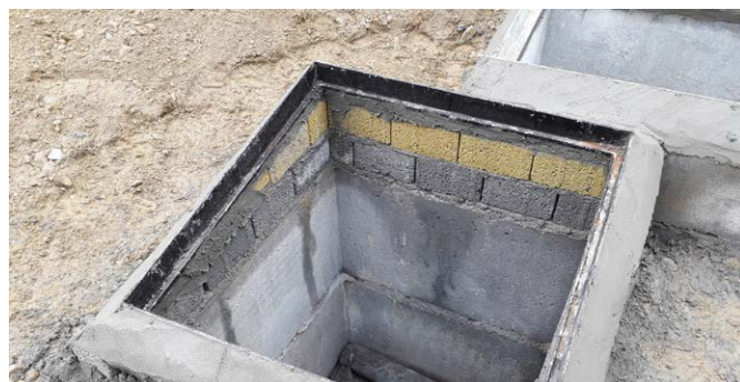
Imagem 4: Assentamento não conforme de tampa, sobre base fraca.
